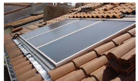
Solarthermiekollektor in Lissabon in den Bestand integriert
